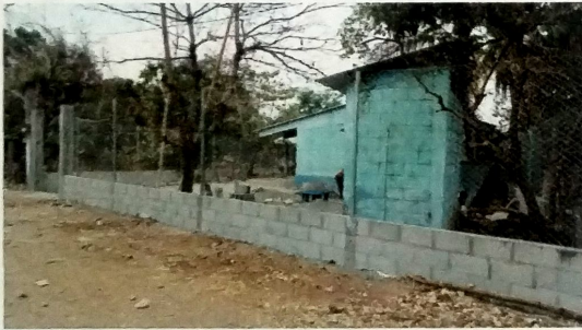
Foto 9: TRABAJOS EXTERIORES , -Vista de muro de block en fachada frontal con tubo HG Y malla calibre 12.
