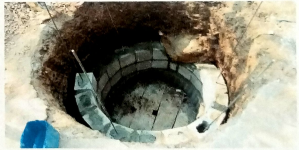
Foto 10: TRABAJOS EXTERIORES Vista de conformacion de brocal para pozo para extraccion de agua potable.
